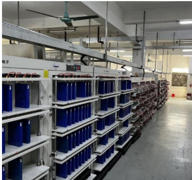
(D) 使用済みバッテリー向け充放電機器（容量測定を実施中）
