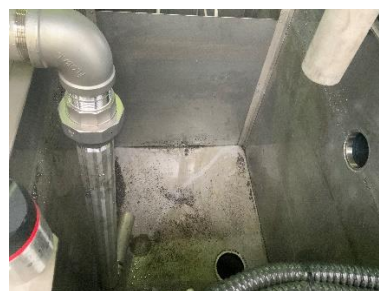
トラブル発生直後の循環水槽内
