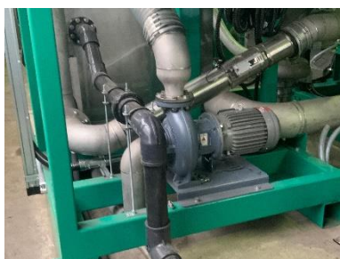
不具合を起こした循環流ポンプ（2021 年1月度交換対応済み）
